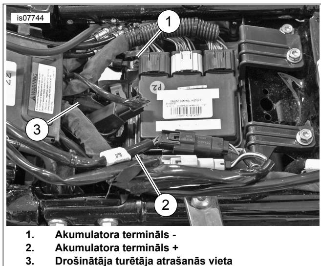
Attēls 9 Akumulatora savienojums
